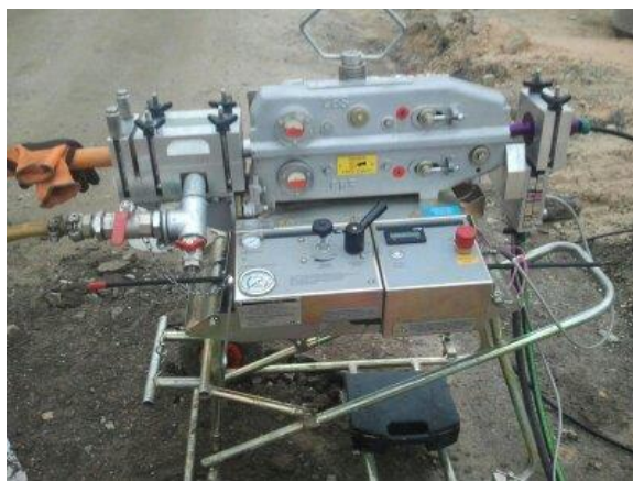
1.attēls Augstspiediena kabeļa pūšanas iekārta
